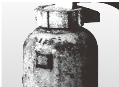
・あばた状の腐食
