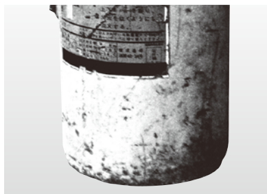
・層状はく離の腐食
