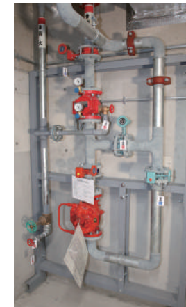
流水検知装置
