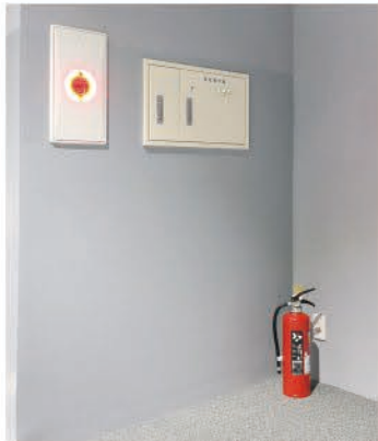
現地操作盤・消火器
