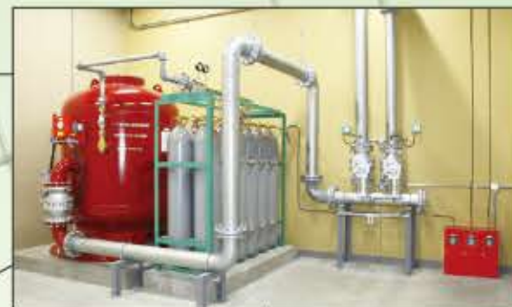
倉庫棟内に設置された粉末消火設備
