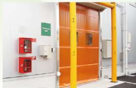
倉庫棟（手動起動装置、復旧弁箱）
