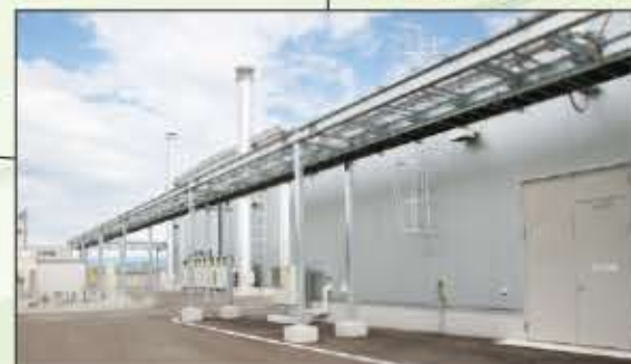
粉末消火設備外側配管
