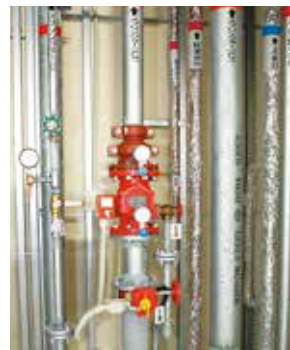
流水検知装置
