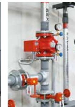
流水検知装置
