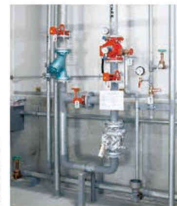
アラーム弁 流水検知装置
