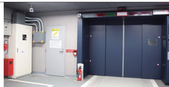
機械式駐車設備
