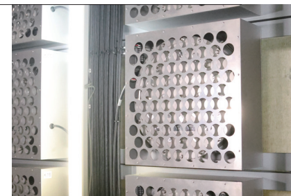
K/SMOKE GAS 放射器
