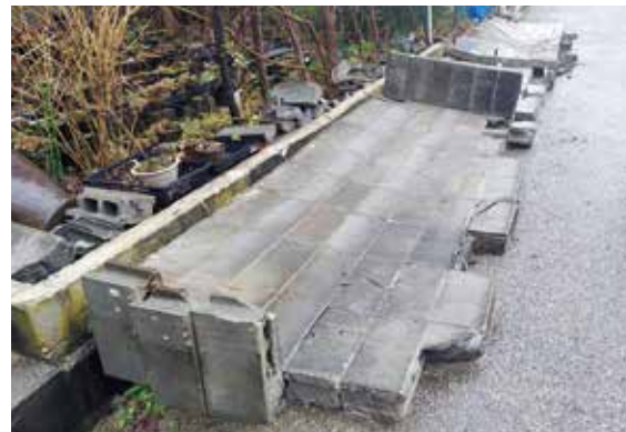
2024年の能登半島地震で倒壊したブロック塀 撮影：徳島大学環境防災研究センター 上月康則氏
