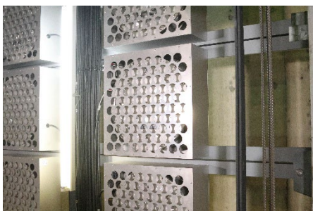
K/SMOKE GAS 放射器
