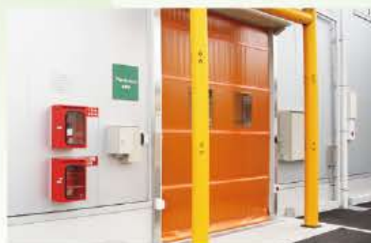
倉庫棟（手動起動装置、復旧弁箱）
