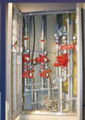
流水検知装置
