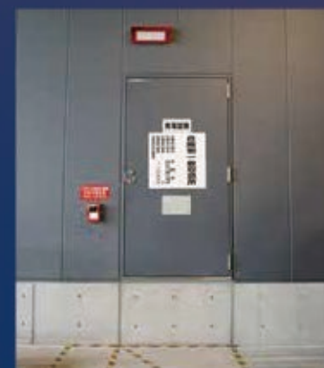
出入口が高い電気室
