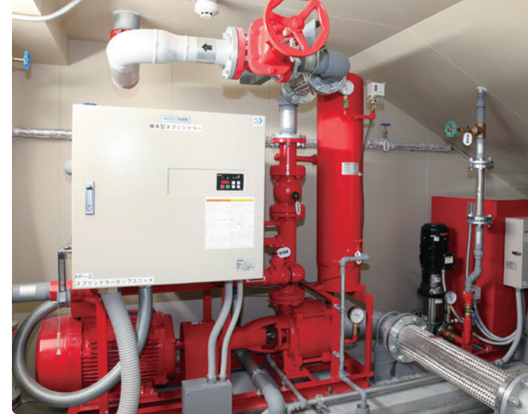
スプリンクラーポンプユニット
