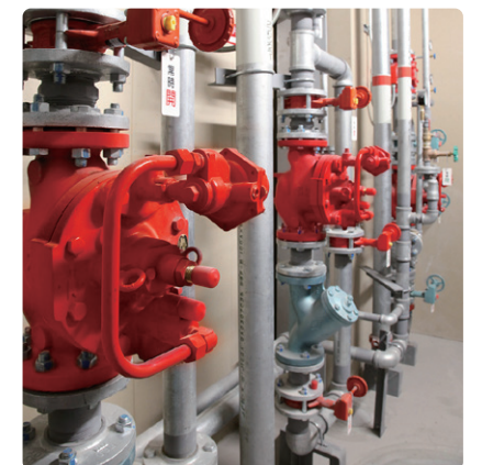
スプリンクラーアラーム弁室
