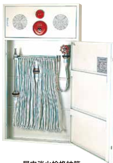
屋内消火栓格納箱
