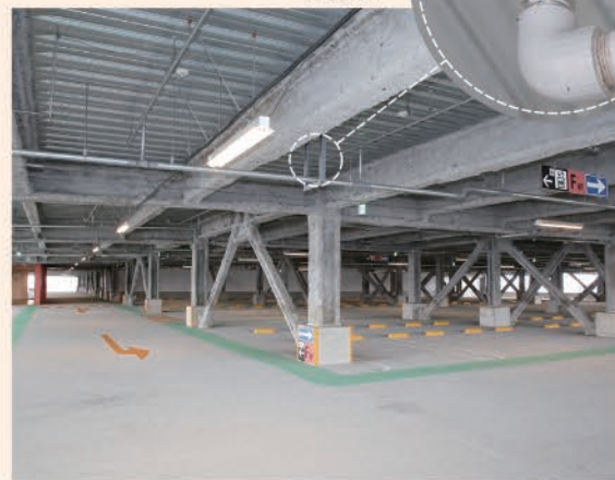
特定駐車場用泡消火設備 (CXシステムⅢ)
