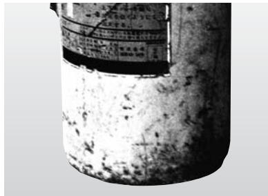
・層状はく離の腐食
